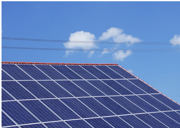
Photo-Voltaik-Anlage - Foto: © lichtkunst.73 / pixelio.de
